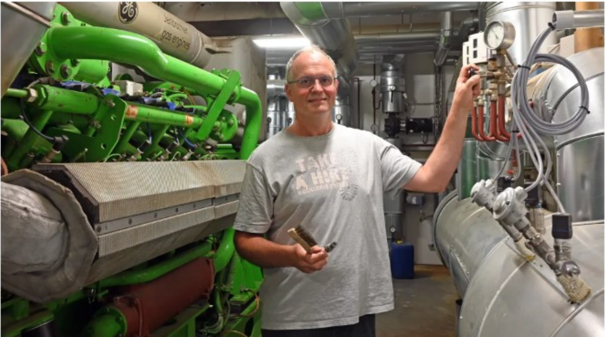
Marco Seith (48) vor dem Motor, der das Methan-Gas aus der Biogas-Anlage verbrennt Foto: Karina Palzer
