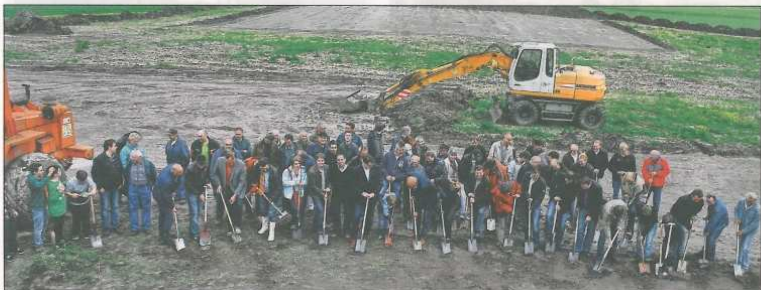
Der gemeinsame erste Spatenstich machte es deutlich: Hier entsteht ein Gemeinschaftsprojekt mit der Beteiligung von möglichst vielen Bürgern, die sich auf den Weg gemacht haben in ein neues Energiezeitalter. Im Hintergrund entsteht ein großes Silo mit drei Kammern.
